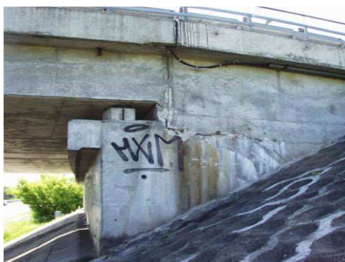
Rys. 3.182. Przemieszczenie przęsła lub przyczółka powodujące całkowity zanik szczeliny dylatacyjnej, brak możliwości swobodnego wydłużania przęsła
