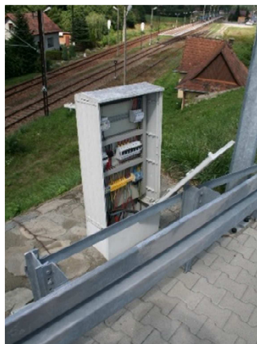
Rys. 3.388. Uszkodzenie szafy rozdzielczej/sterowniczej – zniszczone drzwi
