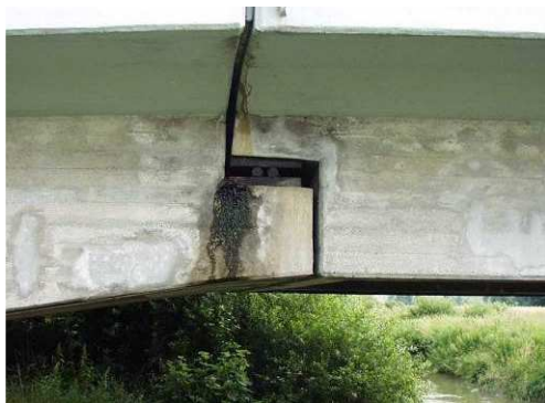
Rys. 3.306. Zanieczyszczony przegub, przecieki wody, beton skorodowany w obrębie przegubu
