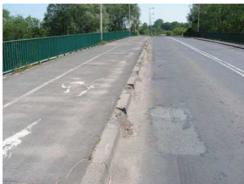
Rys. 3.44. Krawężnik zniszczony w ok. 25%, zbyt małe spadki poprzeczne na chodniku i ścieżce rowerowej
