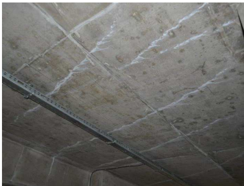
Rys. 3.127. Liczne rysy poprzeczne o rozwar-tości do 0.1 mm z białymi wyługowaniami oraz lokalne zawilgocenie na spodniej powierzchni płyty pomostu sprężonego dźwigara o prze-kroju skrzyńkowym
