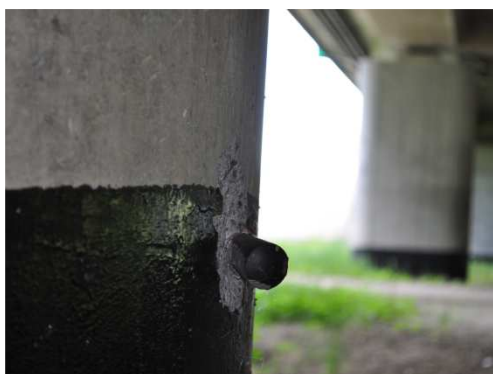
Rys. 3.394. Pojedynczy reper uszkodzony mechanicznie (na obiekcie znajduje się 18 reperów)
