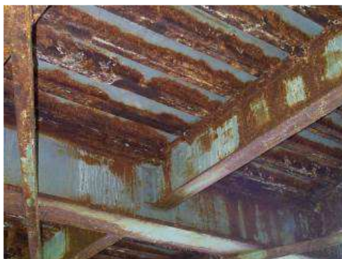
Rys. 3.137. Korozja pomostu ortotropowego, przecieki wody
