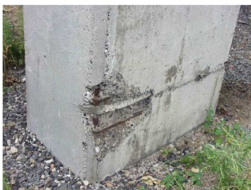
Rys. 3.229. Przegubowe połączenie słupa obiektu ramownicowego z fundamentem. Łożysko przegubowe betonowe z zablokowaną możliwością obrotu, elementy deskowania z okresu budowy ograniczają obrót przegubu (powoduje to uszkodzenia na powierzchniach zewnętrznych w otoczeniu przegubu)
