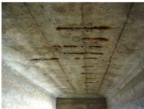
Rys. 3.122. Ubytki betonu i korozja zbrojenia na ok. 5% powierzchni płyty pomostu
