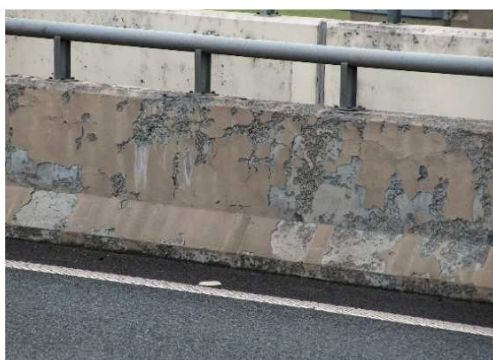
Rys. 3.55. Całkowite zniszczenie antykorozyjnego zabezpieczenia powierzchniowego betonowej bariery ochronnej. Ubytki i złuszczenie betonu (korozja) obejmują ponad 30% powierzchni bariery ochronnej
