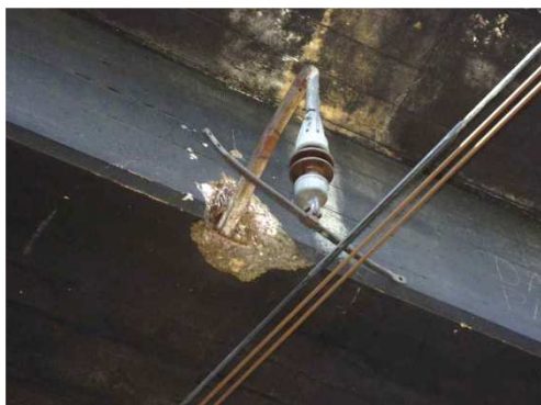
Rys. 3.373. Osłabienie zamocowania odbojnicy sieci trakcyjnej
