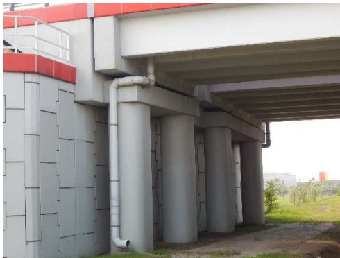
Rys. 3.261. Przyczółek dwudzielny, część przednia (ramownica z betonu monolitycznego) oraz część tylna (z gruntu zbrojonego) niewykazujące uszkodzeń
