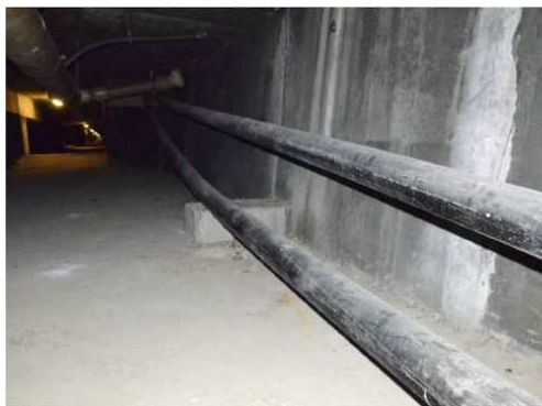
Rys. 3.358. Zerwanie swobodnego kabla sprężającego we wnętrzu dźwigara o przekroju skrzynkowym, kablobetonowy dźwigar główny w stanie przedawaryjnym
