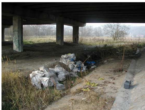
Rys. 3.303. Wysypisko śmieci pod obiektem, sucha roślinność, lokalne ubytki i nierówności terenu Kod uszkodzenia: NT, WT, UT, PT Ocena: 3
