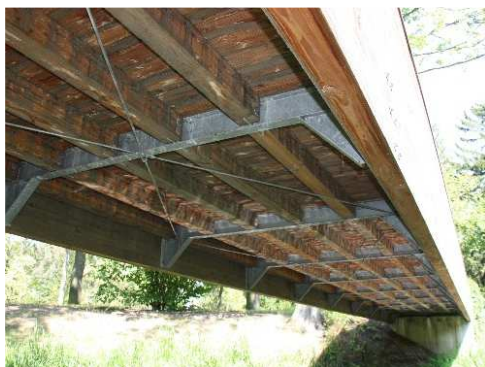
Rys. 3.140. Zawilgocenia, zacieki oraz miejscowa korozja drewna
