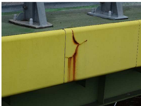
Rys. 3.81. Uszkodzenie zewnętrznej powierzchni deski gzymsowej z polimerobetonu, rysy i pęknięcia powłoki dekoracyjno-ochronnej, korozja zbrojenia w obrębie uchwytów mocujących deski gzymsowe do zbrojenia kapy chodnikowej
