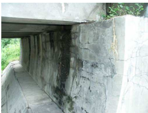
Rys. 3.253. Intensywne zarysowanie ściany czołowej, korozja i ubytki betonu, wegetacja roślin na ławie podłożyskowej, zawilgocenia spowodowane przeciekiem przez urządzenia dylatacyjne
