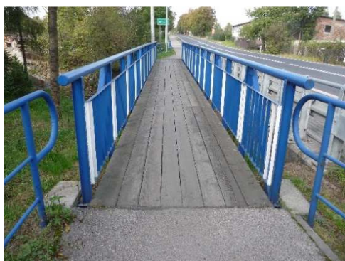
Rys. 3.141. Drewniany pokład podłużny pełniący funkcję pomostu oraz nawierzchni chodnika kładki. Przebarwienie i zawilgocenie desek wskazuje na zużycie się środków impregacyjnych
