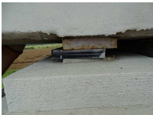
Rys. 3.215. Łożysko elastomerowe w wadliwym położeniu, uszkodzenie powłok malarskich, korozja powierzchniowa górnej blachy nadłożyskowej
