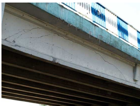
Rys. 3.172. Zniszczenie skrajnej belki typu WBS na skutek uderzenia przez pojazd nienormalny, pęknięcie środnika, ubytki i zarysowanie betonu, możliwe zerwanie splotów sprężających oraz prętów zbrojenia miękkiego
