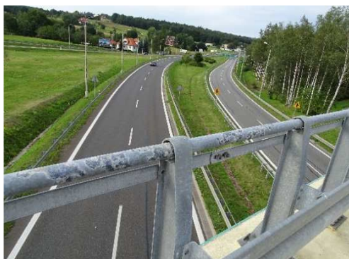
Rys. 3.54. Lokalne uszkodzenie antykorozyjnej powłoki cynkowej, tzw. biała korozja, obejmujące do 5% powierzchni bariery ochronnej
