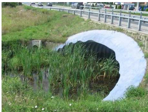
Rys. 3.305. Nadmierna wegetacja roślin utrudniająca przepływ wody Kod uszkodzenia: WT Ocena: 3
