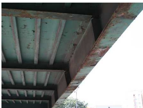
Rys. 3.196. Deformacja dźwigara blachowniowego kładki na skutek uderzenia przez pojazd, pęknięcie żeber pionowych podpierających ortotropowy pomost, zniszczenie antykorozyjnych powłok malarskich, rozległa korozja powierzchniowa
