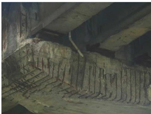
Rys. 3.271. Ubytki betonu oczepu oraz korozja zbrojenia stwarzające zagrożenie dla bezpieczeństwa konstrukcji
