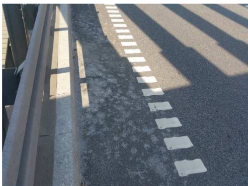
Rys. 3.91. niesprawne odwodnienie z poziomu izolacji płyty pomostu, lokalny brak drożności/skuteczności drenażu, wysięki wody i lokalne zastoiska na nawierzchni jezdni
