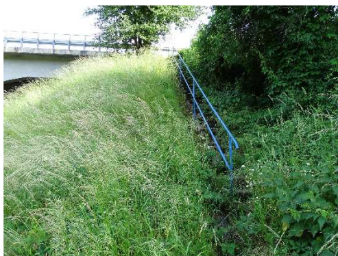
Rys. 3.1. Zbyt bujna wegetacja roślin (traw, drzew, krzewów) występująca na ponad 30% powierzchni stożków, zagrażająca ich trwałości. Wegetacja mchów na schodach skarpowych, korozja i ubytki betonu stopni schodów
