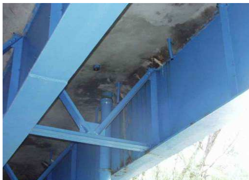
Rys. 3.107. Lokalne przecieki w sąsiedztwie wpustu i sączków – powierzchnia przecieków nieprzekraczająca 5% powierzchni płyty pomostu
