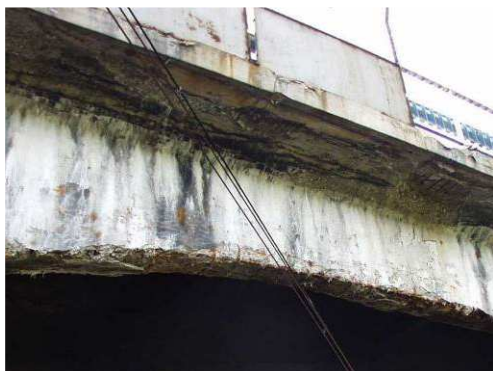
Rys. 3.165. Osady, wykwyty i ubytki betonu, korozja zbrojenia w skrajnym dźwigarze przekraczająca 20% przekroju poprzecznego
