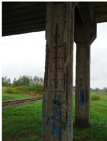
Rys. 3.280. Ubytki betonu w prefabrykowanym słupie filara oraz korozja zbrojenia stwarzające zagrożenie dla bezpieczeństwa konstrukcji
