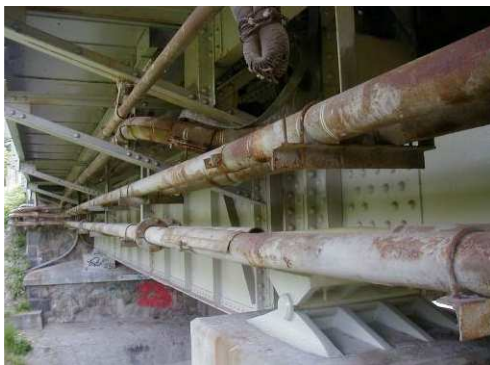
Rys. 3.366. Zniszczenie zabezpieczeń antykorozyjnych i korozja urządzeń obcych
