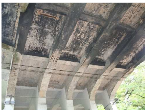
Rys. 3.121. Ubytki i korozja betonu oraz korozja odsłoniętego zbrojenia, wykwyty (białe osady), zanieczyszczenie sadzą spodu płyty pomostu i dźwigarów
