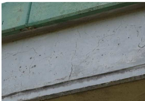
Rys. 3.155. Liczne rysy skurczowe na całej bocznej powierzchni przęsła płytowego z belek prefabrykowanych typu Kujan , niewielkie odpryski betonu
