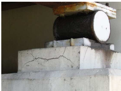
Rys. 3.258. Rysy i pęknięcia w skrajnym ciosie podłożyskowym w 6-dźwigarowym wiadukcie belkowym, zanieczyszczenie smarem do konserwacji łożysk Kod uszkodzenia: RB, NB Ocena: 3 Uwaga: rysy nie mają charakteru przeciążeniowego
