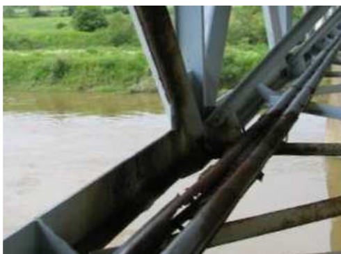
Rys. 3.369. Ubytki korozyjne osłon przewodów telekomunikacyjnych
