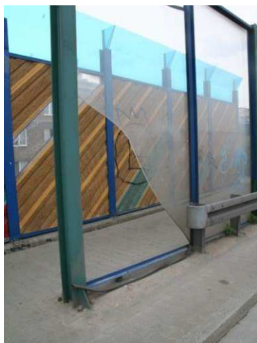
Rys. 3.329. Uszkodzony panel ekranu przeciwhałasowego, estetyka ekranu niezadowalająca (graffiti)
