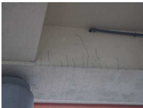
Rys. 3.157. Rysy poprzeczne na spodniej i bocznych powierzchniach dźwigara kablobetonowego nad filarem pośrednim, o rozwarości 0.15 mm
