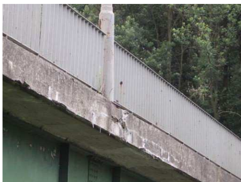
Rys. 3.74. Wykwity, wyługowania, stalaktyty na betonie oraz niewielkie ubytki betonu. Uszkodzenia występują na ok. 20% powierzchni gzymsów
