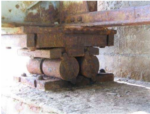
Rys. 3.220. Łożysko stalowe wałkowe skorodowane oraz zanieczyszczone, ruch łożyska utrudniony, widoczne nieprawidłowe położenie łożyska – fotografię wykonano w okresie wysokich temperatur
