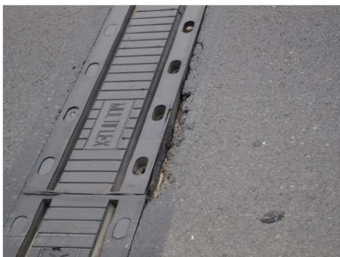
Rys. 3.246. Lokalny ubytek i wykruszenie zaprawy przejściowej przy krawędzi blokowego urządzenia dylatacyjnego, zarysowanie/pęknięcie w spojeniu technologicznym urządzenia z zaprawą przejściową, braki zaślepek zabezpieczających śruby/sworznie. Urządzenie wykazuje niewielkie przecieki
