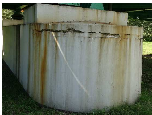
Rys. 3.278. Uszkodzenie głowicy korpusu filara spowodowane przeciekami przez nieszczelne urządzenie dylatacyjne. Rysy oraz ubytki betonu, zacieki, wycieki, osady, zanieczyszczenie korpusu
