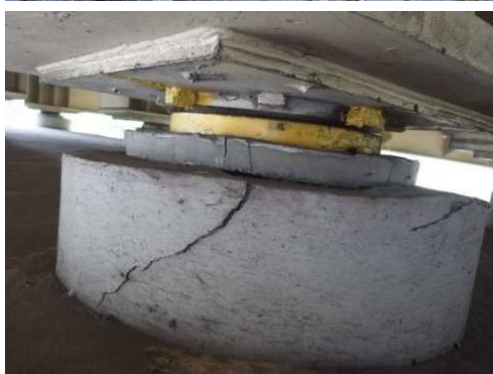
Rys. 3.274. Pęknięcie ciosu podłożyskowego pod stałym łożyskiem garnkowym, lokalne odpryski betonu (rozległe zarysowania podlewki oraz odspojenie podlewki od ciosu podłożyskowego)
