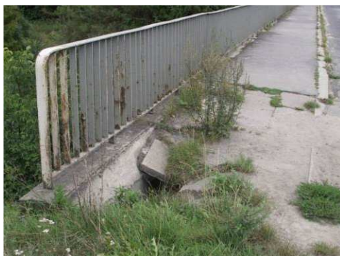
Rys. 3.48. Osunięcie pobocza spowodowane wypłukaniem zasyпки przyczółka
