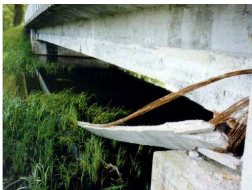
Rys. 3.357. Całkowite uszkodzenie cięgien sprężenia zewnętrznego
