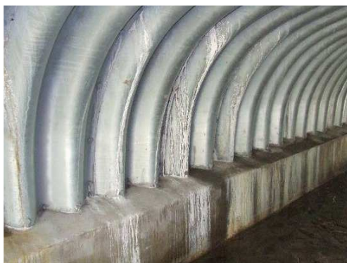
Rys. 3.118. Intensywne przecieki i liczne osady na powłoce z blachy falistej spowodowane wadliwie wykonaną izolacją i nieskutecznym drenażem odwadniającym zasypkę
