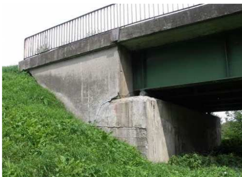
Rys. 3.252. Pęknięcie skrzydła na skutek przemieszczenia (obrotu) przyczółka, brak szczeliny pomiędzy krawędzią dźwigara i ścianką nadłożyskową
