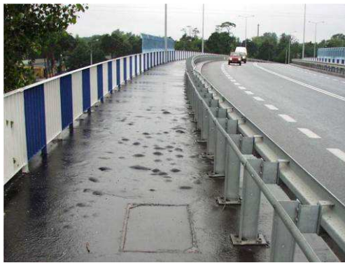
Rys. 3.35. Deformacje nawierzchni bitumicznej do 20 mm na 10% powierzchni chodnika
