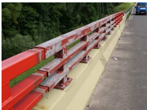
Rys. 3.53. Zniszczenie zabezpieczeń antykorozyjnych obejmujące ponad 30% powierzchni stalowej bariery ochronnej
