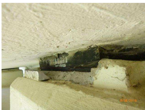
Rys. 3.233. Ubytek/odprysk części podlewki spoza powierzchni jej bezpośredniego kontaktu z podstawą łożyska
