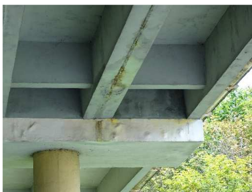
Rys. 3.112. Lokalny przeciek pomiędzy belkami prefabrykowanymi typu Korytkowego , nieprzekraczający 5% długości styków żeber pionowych
