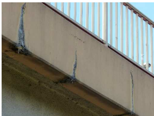
Rys. 3.75. Rysy skurczowe z wykwitami i wyługowaniami oraz stalaktytami występujące regularnie na całej długości gzymsu, uszkodzenia dekoracyjno-ochronnych powłok malarskich
