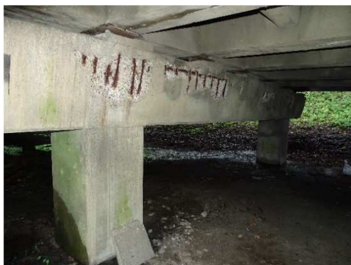
Rys. 3.282. Ubytki betonu oczepek filara spowodowane korozją zbrojenia oraz przeciekiem przez nieszczelne urządzenie dylatacyjne. Wegetacja porostów
