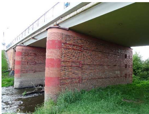
Rys. 3.364. Lokalne uszkodzenia powłoki anty-korozyjnej cięgien wzmocniających filary
