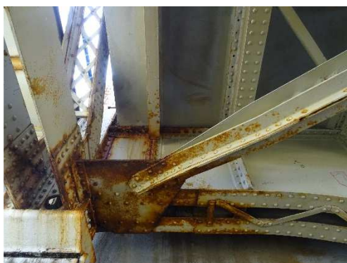
Rys. 3.189. Uszkodzenie węzła w moście kratownicowym, lokalne uszkodzenia powłoki antykorozyjnej i miejscowa korozja elementów dźwigara kratowniczowego oraz poprzecznicy podporowej
