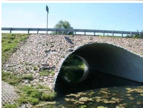
Rys. 3.18. Ubytki i przemieszczenie kamiennego umocnienia skarpy zasyпки oraz niewielkie rozmycia spowodowane niekontrolowanym spływem wody z jezdni
