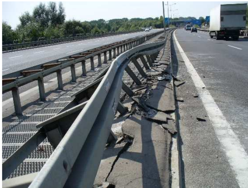
Rys. 3.66. Zniszczony odcinek bariery ochronnej, przemieszczenie bariery, zniszczone zakończenia 12 słupków w betonie kapy/pobocza technicznego wyniesionego
