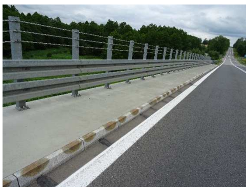
Rys. 3.43. Przebarwienia na krawężnikach kamiennych obejmujące ponad 30% prefabrykatów wbudowanych w obiekt
