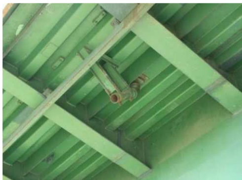
Rys. 3.133. Miejscowe zniszczenie powłoki antykorozyjnej
