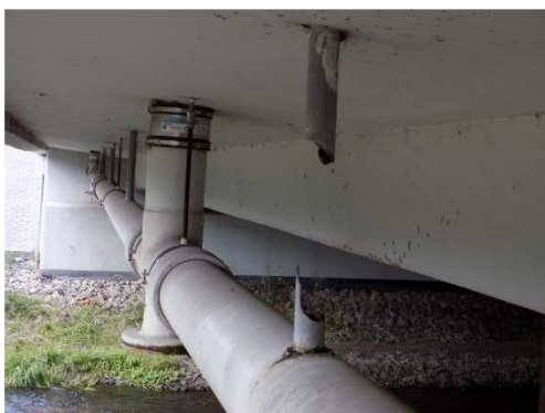
Rys. 3.94. Brak ciągłości jednej rurki odpływowej sączka
