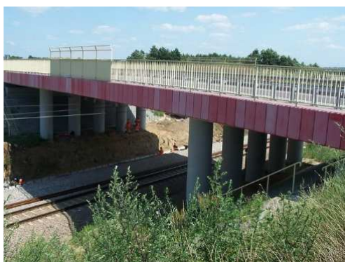
Rys. 3.76. Pierwsze objawy uszkodzeń, przebarwienia elementów gzymsu pogarszające estetykę
