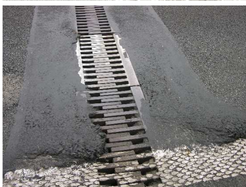
Rys. 3.250. Deformacja asfaltu lanego strefy przejściowej wzdłuż segmentów palczastego urządzenia dylatacyjnego, deformacje przekraczające 20 mm
