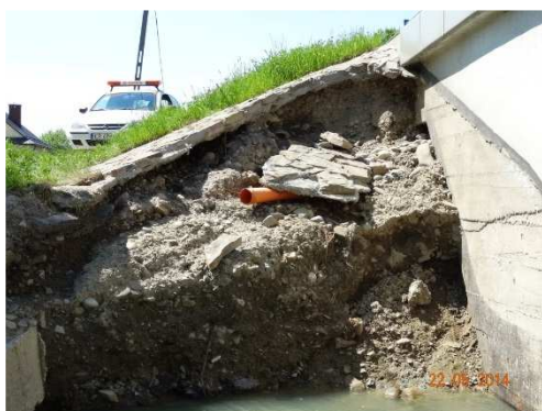
Rys. 3.12. Osunięcie i rozmycie stożka nasypu powodujące odsłonięcie skrzydełka oraz stan awaryjny nasypu przy przyczółku. Całkowite zniszczenie betonowych umocnień stożków
