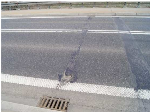
Rys. 3.33. Uszkodzenie nawierzchni nad drewnem poprzecznym pomiędzy wpustami. Pęknięcia, ubytki i deformacje – ślady po naprawach nawierzchni
