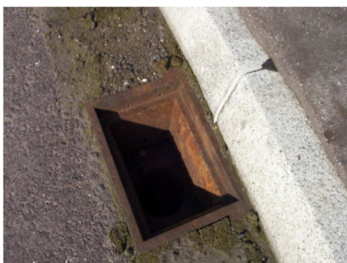
Rys. 3.97. Brak kratki ściekowej wpustu
