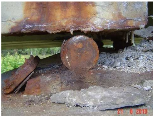
Rys. 3.221. Łożysko stalowe wałkowe skorodowane i zanieczyszczone – w stanie awaryjnym. Płyta górna wypadła zwałka
