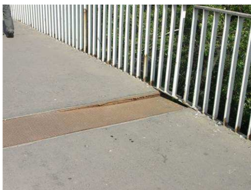
Rys. 3.242. Przemieszczenie (obniżenie) przekrycia z blachy stalowej urządzenia dylatacyjnego o ponad 10 mm
