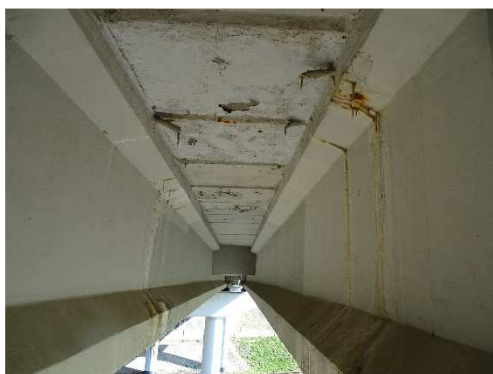
Rys. 3.120. Lokalny przeciek przez płytę pomostu, osady, wykwyty oraz uszkodzenie antykorozyjnych powłok ochronnych
