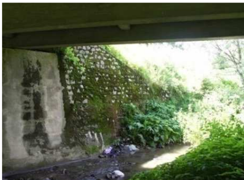
Rys. 3.315. Konstrukcja oporowa zawilgocona (występują przecieki) i pokryta roślinnością
