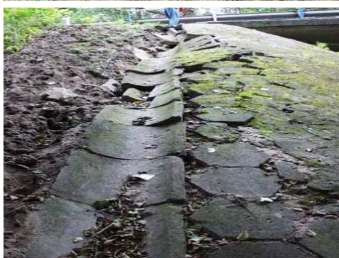
Rys. 3.102. Przemieszczenie i zniszczenie elementów prefabrykowanych ścieku na skarpię, ubytki i zanieczyszczenia betonu
