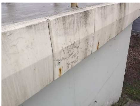
Rys. 3.73. Zanieczyszczenie zewnętrznych powierzchni desek gzymsowych pogarszające estetykę obiektu, rysy skurczowe oraz ogniska korozji zbrojenia na dekoracyjno-ochronnej powłoce nieprzekraczające 5% powierzchni desek
