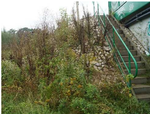
Rys. 3.5. Wegetacja roślin na kamiennych umocnieniach stożków zagrażająca trwałości, obłuzowanie kamiennych elementów umocnienia występujące na ok. 30% powierzchni
