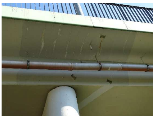
Rys. 3.158. Rysy poprzeczne (przeciążeniowe) z wyługowaniami na spodniej powierzchni wsporników podchodnikowych nad filarem pośrednim, rysy ukośne (przeciążeniowe) na spodniej powierzchni żelbetowego dźwigara płytowego
