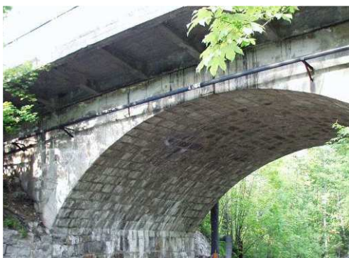
Rys. 3.205. Przecieki wody, osady i wykwyty na powierzchni sklepienia świadczące o korozji spoin elementów sklepienia
