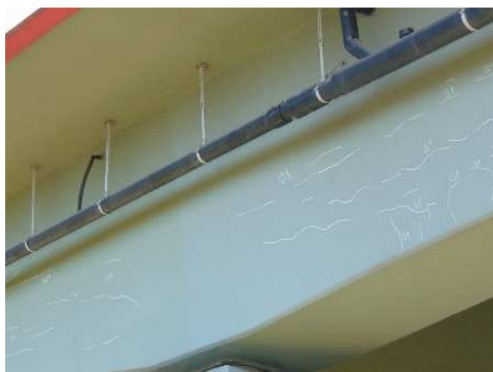
Rys. 3.156. Liczne rysy poziome o rozwarłości do 0.1 mm na bocznej powierzchni dźwigara kablobetonowego
