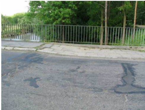
Rys. 3.20. Nawierzchnia na dojazdach obniżona o ok. 50 mm, powodująca zwiększone oddziaływania dynamiczne na konstrukcję i przyspieszoną degradację urządzenia dylatacyjnego. Występują również zastoiska wody i spękania asfaltu
