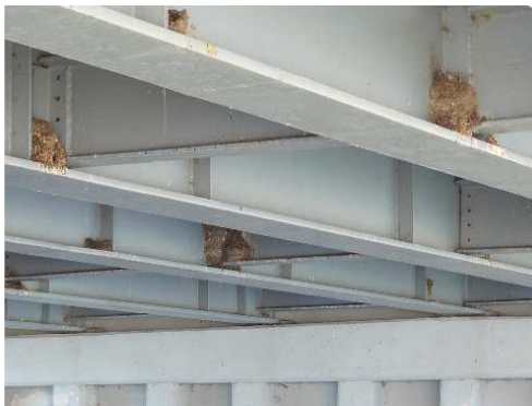
Rys. 3.185. Rozległe zanieczyszczenie środników i pasów dolnych dźwigarów blachownicowych ptasimi odchodami, sprzyjające uszkodzeniom powłok malarskich oraz korozji elementów stalowych
