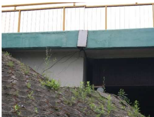
Rys. 3.256. Przemieszczenie przyczółka wiaduktu o schemacie belki ciągłej. Pęknięcie skrzydeł, uskok na balustradzie, zaciśnięcie się urządzenia dylatacyjnego, wałek łożyska w położeniu poza słupkiem (żebrem) podporowym dźwigara głównego Kod uszkodzenia: PB, RB Ocena: 1 Uwaga: konieczne jest wykonanie ekspertyzy
