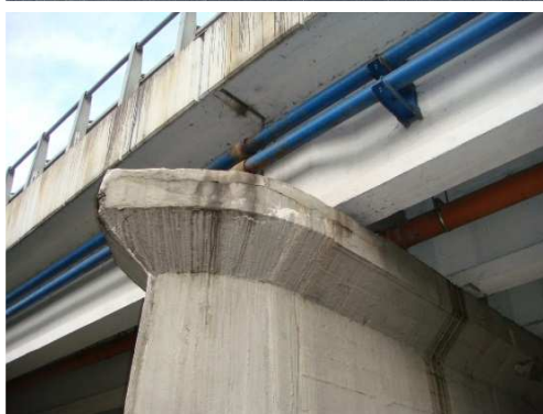
Rys. 3.285. Uszkodzenia ławy podłożyskowej (głowicy korpusu) filara spowodowane przeciekiem przez nieszczelne urządzenie dylatacyjne. Zacieki i wycieki, rysy, osady oraz zanieczyszczenie korpusu
