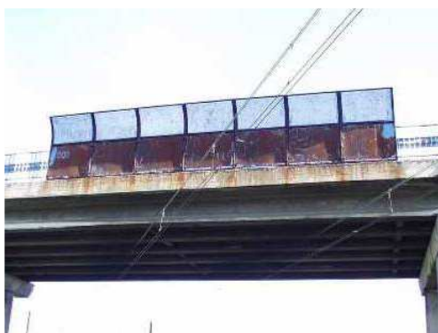
Rys. 3.69. Silna korozja osłony przeciwporażeniowej, perforacja elementu
