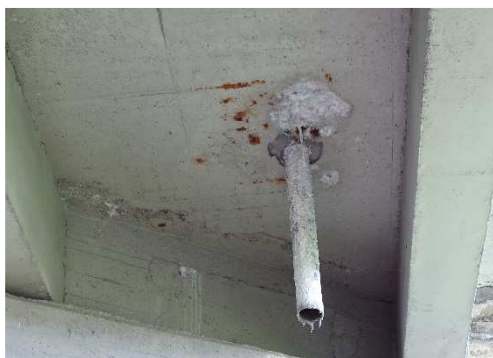
Rys. 3.108. Lokalne przecieki w sąsiedztwie sączków – powierzchnia przecieków nieprzekraczająca 5% powierzchni płyty pomostu
