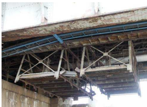
Rys. 3.383. Zniszczenie powłoki antykorozyjnej, korozja elementów wózka rewizyjnego, uszkodzenie drewnianych elementów pomostu wózka, zablokowanie ruchu
