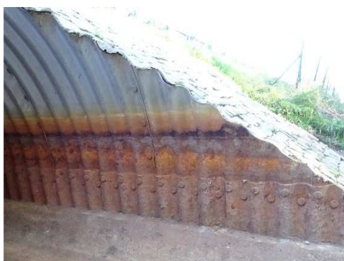
Rys. 3.210. Ubytki korozyjne, miejscowe zniszczenie struktury materiału powłoki z blachy falistej
