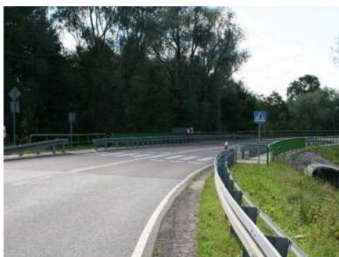
Rys. 3.24. Brak uszkodzeń na dojazdach do obiektu mostowego o konstrukcji gruntowo-powłokowej
