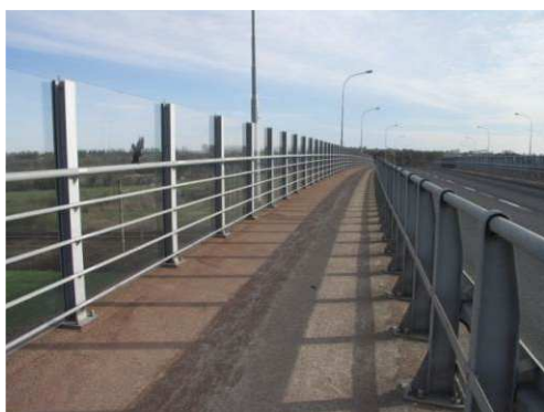
Rys. 3.327. Ekran przeciwhałasowy w dobrym stanie
