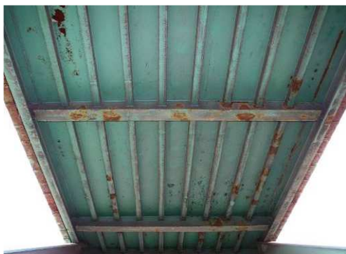
Rys. 3.135. Zniszczenie powłoki antykorozyjnej i miejscowa korozja pomostu
