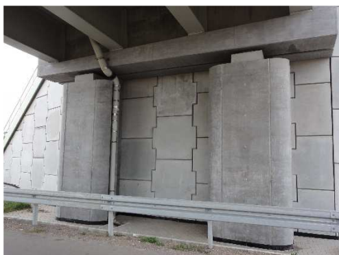
Rys. 3.319. Część tylna przyczółka dwudzielnego z gruntu zbrojonego – lokalne osady na betonowych panelach oraz brak równoległości szczelin pomiędzy panelami. Wskazuje to na miejscowe przemieszczenia, nie ma jednak zagrożenia trwałości
