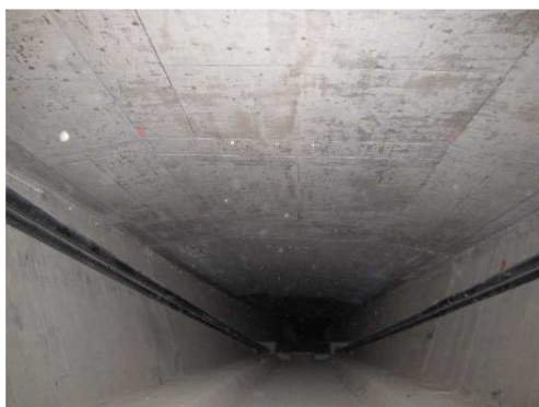
Rys. 3.360. Cięgna bez uszkodzeń, występują jedynie lokalne zanieczyszczenia osłon niemające wpływu na trwałość
