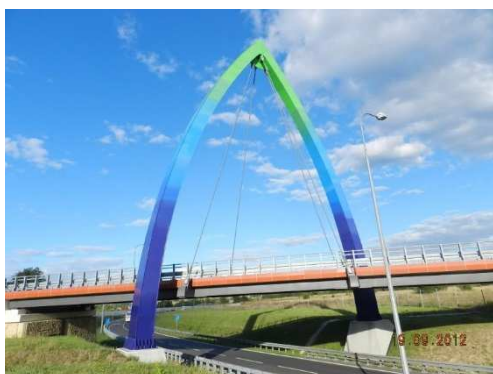
Rys. 3.291. Stalowy pylon o nietypowej konstrukcji oraz betonowe fundamenty pylonu niewykazujące uszkodzeń
