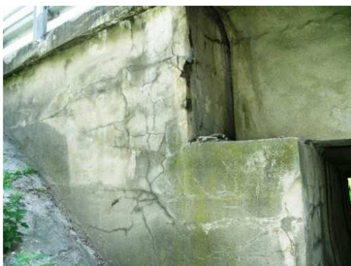
Rys. 3.254. Zarysowanie powierzchni korpusu i skrzydła, korozja i ubytki betonu
