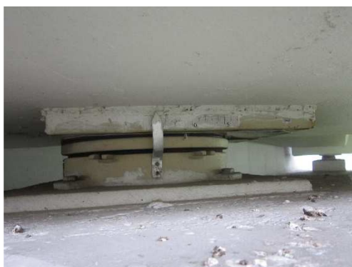
Rys. 3.234. Łożysko garnkowe z całkowicie nieczytelną skalą pomiarową (podziałką kre-skową) wskaźnika położenia (przemieszczeń) oraz zamalowaną tabliczką znamionową. Uszkodzenie dotyczy ponad 20% łożysk
