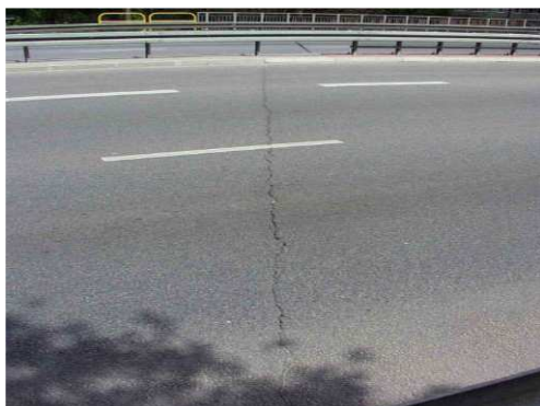
Rys. 3.239. Pęknięcie pojedyncze nawierzchni nad krawędzią płyty pomostu (uciąglenie nawierzchni), strefa dylatacyjna niewykazująca przecieków
