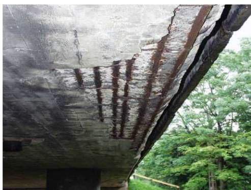
Rys. 3.176. Ubytki betonu, korozja betonu, korozja zbrojenia
