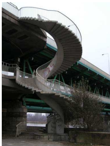
Rys. 3.378. Niewielkie, miejscowe ubytki powłoki malarskiej, graffiti
