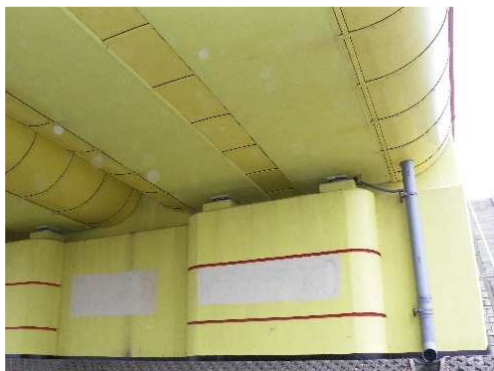
Rys. 3.70. Osłony boczne i środkowe, pełniące funkcję elementów dekoracyjnych/maskujących, w dobrym stanie
