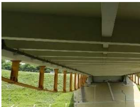
Rys. 3.362. Lokalne zanieczyszczenia osłon (rury HDPE) zewnętrznych kabli sprężających niemające wpływu na estetykę i trwałość
