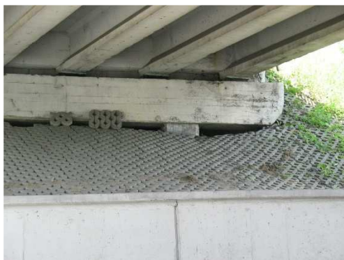
Rys. 3.11. Osiadanie skarpy nasypu drogowego w obrębie przyczółka zatopionego w nasypie zagrażające stateczności skarpy oraz sprzyjające powstawaniu wybojów na dojazdach obiektu. Ubytki i przemieszczenia elementów umocnień skarpy
