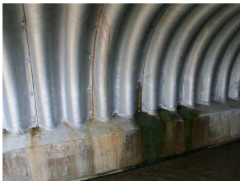
Rys. 3.208. Zacieki widoczne na styku blach falistych, korozja powłoki metalizacyjnej na stykach blachy
