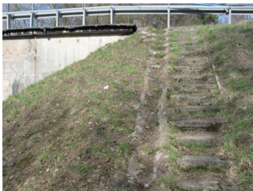
Rys. 3.15. Zanieczyszczenia, wegetacja roślin na schodach dla obsługi, ubytki betonu schodów, całkowicie zniszczona balustrada
