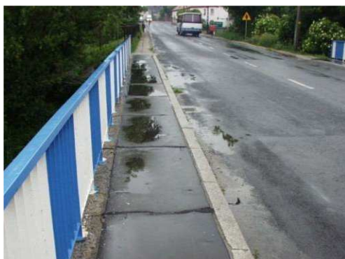
Rys. 3.37. Brak spadku umożliwiającego odpływ wody, widoczne liczne zastoiska na powierzchni większej niż 30%, brak spoin między belką podporęczową i krawężnikiem a nawierzchnią chodnika
