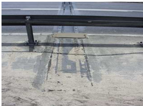
Rys. 3.235. Zanieczyszczone blokowe urządzenie dylatacyjne, niewykazujące oznak nieuszczelnności, korozja blachy osłonowej
