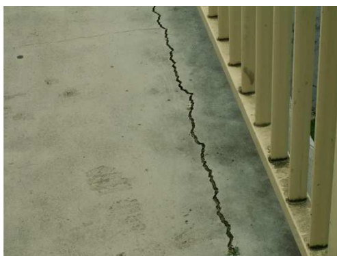
Rys. 3.51. Pęknięcie podłużne wzdłuż belki podporęczowej, o dużej rozwarości
