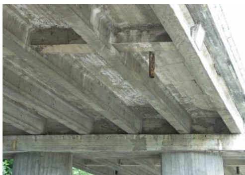
Rys. 3.110. Rozległe przecieki świadczące o braku szczelności izolacji
