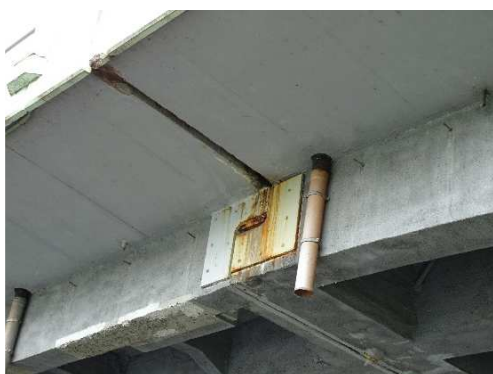
Rys. 3.312. Przecieki wody, beton skorodowany w obrębie przegubu, korozja blachy wzmacniającej boczne powierzchnie przegubu
