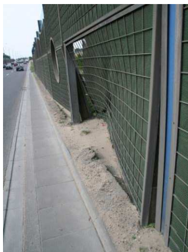
Rys. 3.330. Uszkodzony panel ekranu przeciwhałasowego
