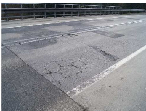
Rys. 3.30. Pęknięcia siatkowe, ubytki i deformacje (koleiny), zanieczyszczenie piaskiem poboczny utwardzonych
