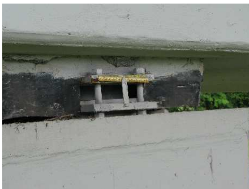
Rys. 3.222. Łożysko garnkowe z ograniczeniem ruchu przez niezdemontowane śruby w uchwytach montażowych/transportowych. Pęknięcia fartucha ochronnego, skorodowany i zanieczyszczony wskaźnik oraz skala przemieszczeń (położenia) łożyska.
