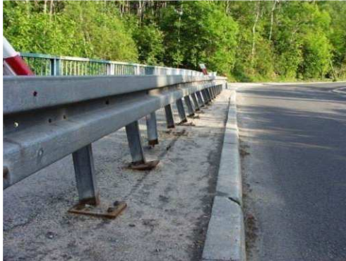
Rys. 3.65. Przemieszczenie bariery, uszkodzenie połączenia słupków z pomostem na odcinku 30 m, stanowiącym ok. 30% długości bariery
