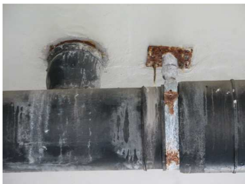
Rys. 3.99. Zaawansowana korozja zagrażająca trwałości elementów mocujących przewody odprowadzające wody opadowe, zanieczyszczenie przewodu zbiorczego
