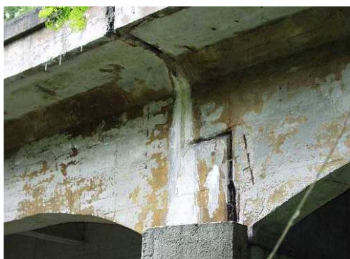
Rys. 3.308. Zanieczyszczona szczelina dylatacyjna, przecieki, osady, wykwity i ubytki betonu, korozja zbrojenia
