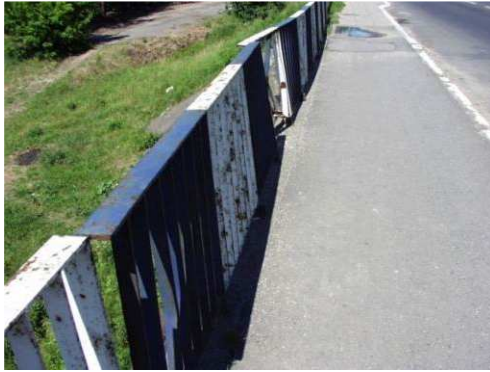
Rys. 3.64. Deformacja i przemieszczenie balustrady o ok. 20 cm na odcinku ok. 5 m, deformacja 6 szczebli, utrata ciągłości balustrady w dwóch miejscach, uszkodzenie zamocowania 3 słupków
