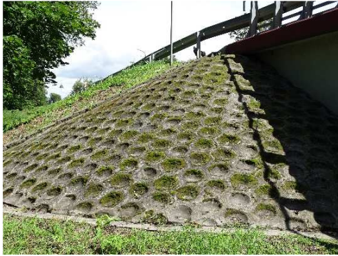
Rys. 3.3. Wegetacja mchów na betonowych umocnieniach stożków (zagrożenie korozją biologiczną), zanieczyszczenia występujące na ponad 30% powierzchni umocnień, zagrażające trwałości stożków. Początki korozji betonu
