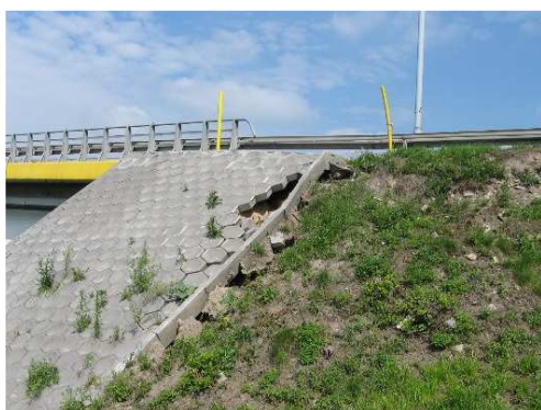
Rys. 3.13. Lokalny ubytek i rozmycie nasypu drogowego (do 10% powierzchni) pod betonowymi elementami umocnienia stożków mogące powodować zagrożenie trwałości skarpy
