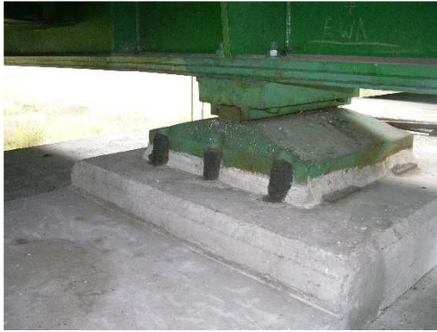
Rys. 3.219. Łożysko stalowe przegubowe nieprzesuwne, niewielkie zanieczyszczenie oraz uszkodzenie powłok malarskich
