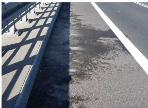
Rys. 3.28. Lokalne zawilgocenie i osady obejmujące do 5% powierzchni. Wysięki wody z poziomu izolacji spowodowane nieskutecznym odwodnieniem izolacji
