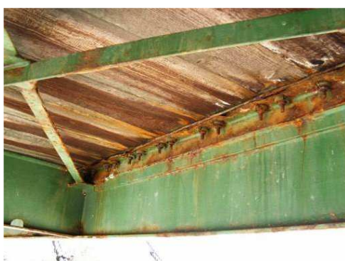
Rys. 3.142. Liczne zawilgocenia i przecieki oraz korozja drewna (gnicie) powodująca zmniejszenie przekroju o ok. 20%
