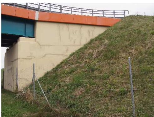
Rys. 3.262. Zarysowania, lokalne przecieki przez korpus i skrzydła, osady oraz rozległe ślady po naprawie rys
