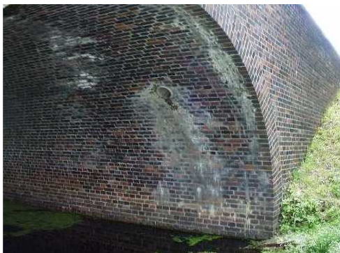
Rys. 3.204. Zacieki, osady i wykwyty na powierzchni sklepienia świadczące o korozji cegieł i ich spoin
