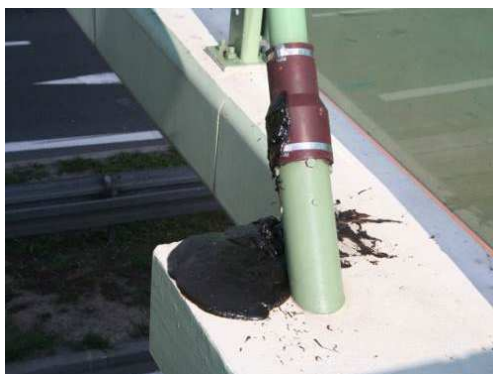
Rys. 3.355. Pęknięcie osłony kabla oraz wyciek materiału wypełniającego osłonę
