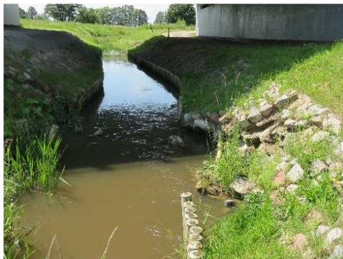
Rys. 3.302. Zniszczenie fragmentu umocnień koryta rzeki, ubytki (rozmycie) skarp Kod uszkodzenia: UT, UD, UK, PK, PT Ocena: 3
