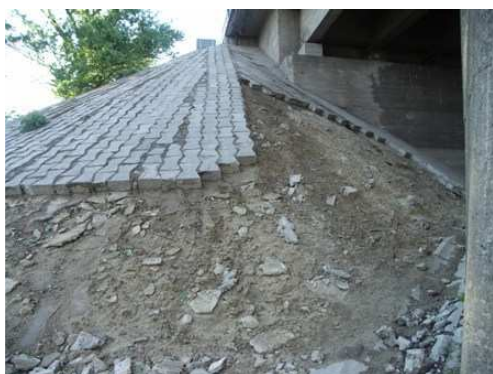
Rys. 3.14. Brak ok. 50% elementów betonowych umacniających stożek
