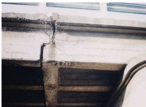
Rys. 3.307. Zanieczyszczony przegub, przecieki, wegetacja roślin i ubytki betonu w strefie oparcia
