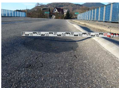
Rys. 3.27. Deformacje nawierzchni (koleiny) o głębokości przekraczającej 100 mm, rysy i pęknięcia asfaltu, zanieczyszczenia. Koleiny uniemożliwiają doływ wody opadowej do urządzeń odwadniających
