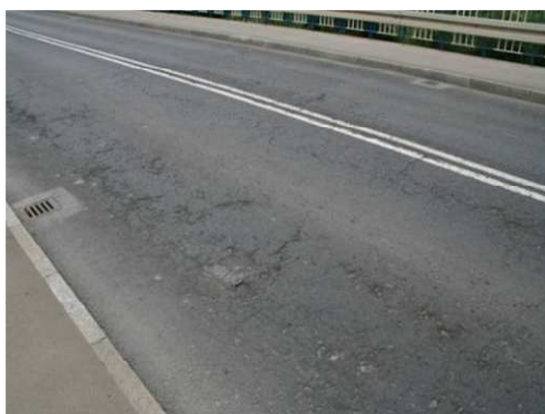
Rys. 3.29. Pęknięcia siatkowe z wykruszeniami występujące na ok. 20% powierzchni jezdni, miejscowe ubytki o wymiarach mniejszych niż 0.1 x 0.1 m
