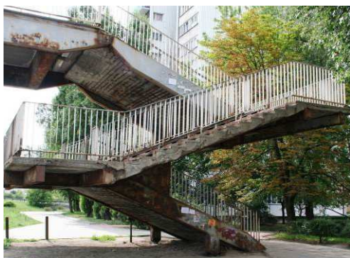
Rys. 3.375. Korozja i ubytki betonu płyty pomostu, silnie zaawansowana korozja stali konstrukcyjnej i zbrojeniowej
