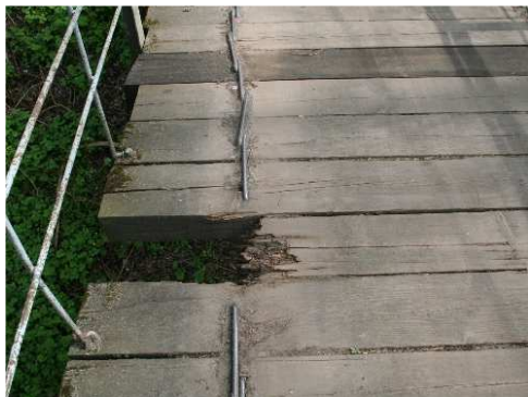
Rys. 3.143. Drewniany pokład poprzeczny pełniący funkcję pomostu oraz nawierzchni chodnika kładki – pęknięcia i próchnica wielu bali pomostu, lokalne ubytki (wyłamane) bali, braki klamer łączących bale
