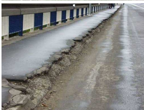
Rys. 3.49. Całkowicie zniszczony krawężnik, widoczne ubytki nawierzchni chodnika
