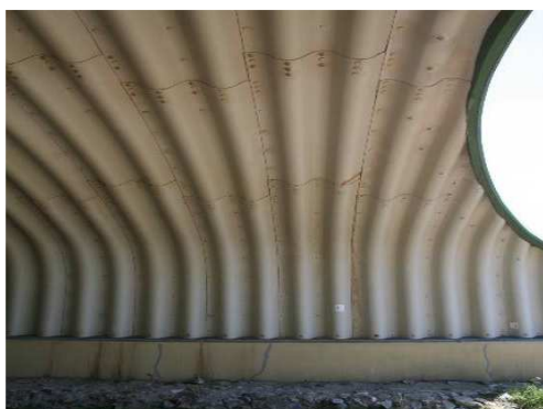
Rys. 3.209. Ślady po przeciekach widoczne na stykach blach konstrukcji, zacieki
