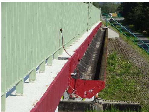
Rys. 3.93. Uszkodzenia żelbetowego koryta odwadniającego – zarysowania betonu na czole i spodniej powierzchni koryta, osady i wykwyty, niewielkie zanieczyszczenie piaskiem, uszkodzenia powłoki malarskiej
