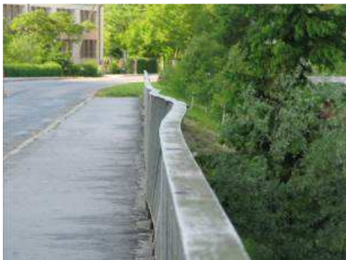
Rys. 3.60. Deformacja o wielkości 10-15 cm w stosunku do pierwotnego położenia, osłabienie zamocowania balustrady do pomostu
