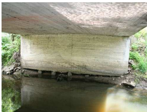
Rys. 3.264. Podmycie fundamentu przyczółka, częściowo odsłonięte prefabrykowane pale fundamentowe
