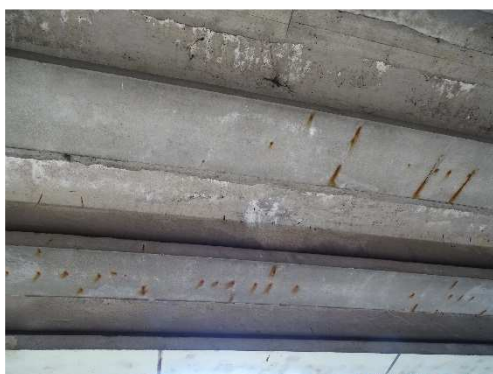
Rys. 3.166. Ubytki zbyt cienkiej otuliny oraz korozja odsłoniętych strzemion na spodniej powierzchni dolnych półek belek typu Płońsk
