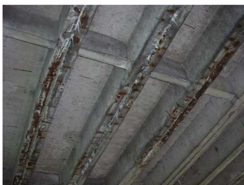
Rys. 3.167. Zniszczenie środków/zeber belek typu Korytko , ubytek, korozja i zarysowania betonu, korozja zbrojenia miękkiego i stali sprężającej, przecieki przez zamki prefabrykatów, osady i wykwyty
