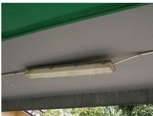
Rys. 3.391. Uszkodzenie zamocowania oświetlenia pod kładką (oprawa znajduje się nad chodnikiem)
