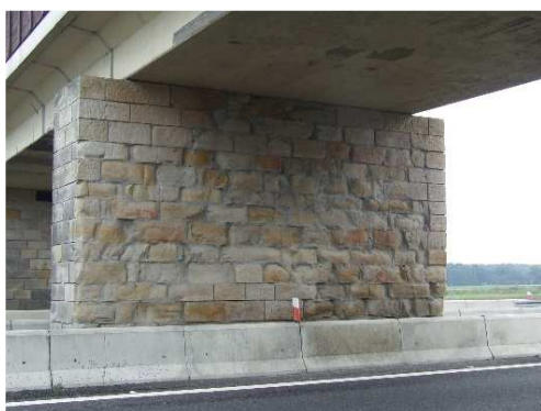
Rys. 3.284. Ubytki kamiennej licówki filara spowodowane wietrzeniem kamienia. Pęknięcia pojedynczych kamieni oblicowania, niewielkie ubytki spoinowania
