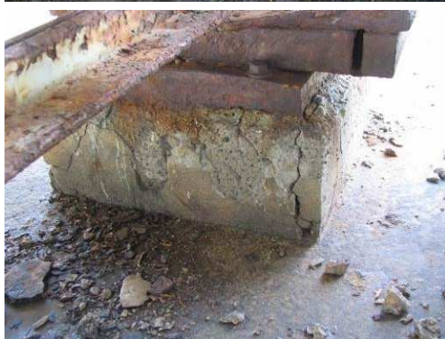
Rys. 3.273. Korozja betonu, rysy, pęknięcie i ubytki betonu ciosu podłożyskowego na filarze
