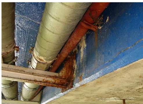
Rys. 3.371. Zaawansowana korozja wspornika podpierającego urządzenie obce. Wspornik przyczynia się do uszkodzeń dźwigara głównego
