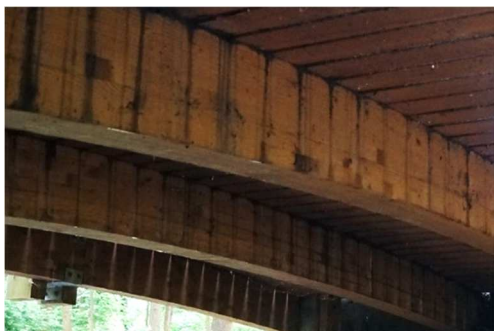
Rys. 3.201. Dźwigary drewniane bez uszkodzeń (brak pęknięć, delaminacji, ubytków itp.), zanieczyszczenia spowodowane zaciekami przez nieuszczelny pomost
