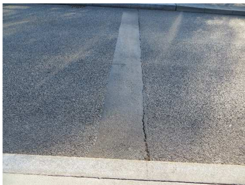
Rys. 3.241. Pęknięcie w spojeniu (styku) technologicznym bitumicznego przykrycia dylatacyjnego z nawierzchnią jezdni/dojazdów, urządzenie dylatacyjne wykazujące niewielkie przecieki
