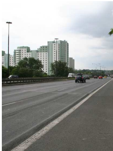
Rys. 3.19. Deformacje nawierzchni na wszystkich pasach ruchu na dojazdach – koleiny o głębokości do 30 mm uniemożliwiają dopływ wody opadowej do urządzeń odwadniających
