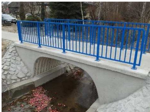
Rys. 3.68. Balustrada na kładce dla pieszych o konstrukcji gruntowo-powłokowej w bardzo dobrym stanie technicznym
