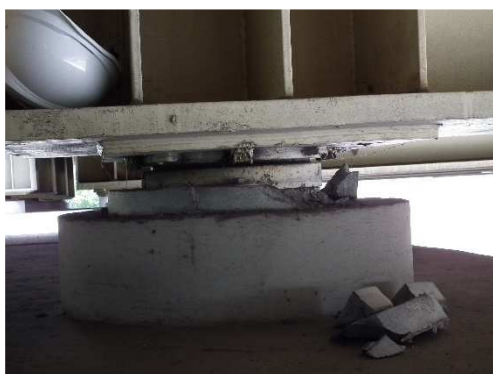
Rys. 3.232. Łożysko garnkowe stałe – niewielki ubytek/odprysk części podlewki spod dolnej powierzchni garnka/cylindra
