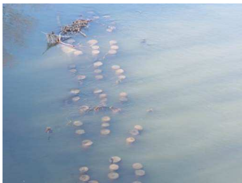
Rys. 3.301. Zbyt wysoko obcięte pale starej podpory w sąsiedztwie nowego mostu, ułatwiające gromadzenie się zanieczyszczeń i utrudniające spływ wody i lodu
