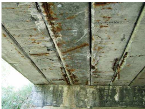
Rys. 3.169. Ubytki betonu, korozja betonu, korozja odsłoniętych prętów zbrojeniowych
