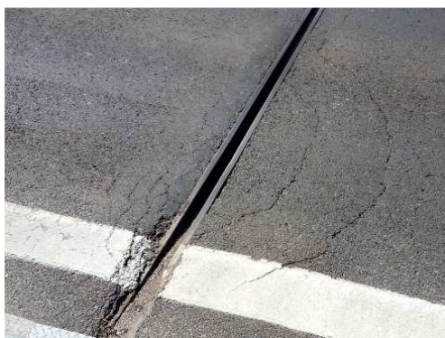
Rys. 3.31. Lokalne rysy, pęknięcia i wykruszenia nawierzchni w obrębie skrajnych profili stalowych modułowego urządzenia dylatacyjnego
