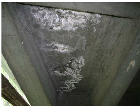
Rys. 3.115. Rozległe przecieki świadczące o braku szczelności izolacji
