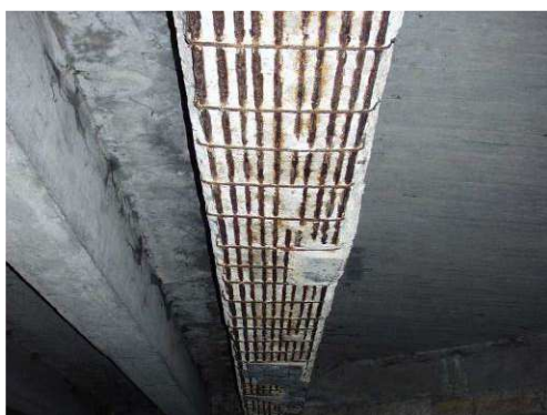
Rys. 3.175. Ubytki betonu, korozja prętów zbrojeniowych powodująca zmniejszenie ich przekroju o ok. 20%
