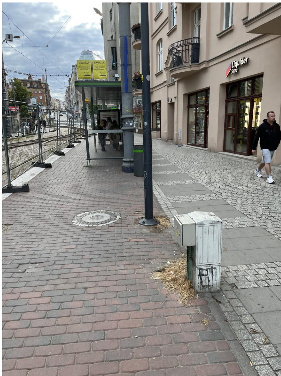
Zdjęcie poglądowe skrzynki przeznaczonej do demontażu.
