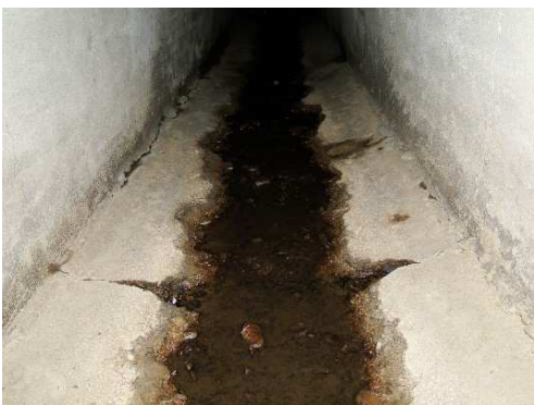
Rys. 4.50. Zniszczenie struktury betonu, ubytki oraz pęknięcia płyty dennej zagrażające nośności przepustu
