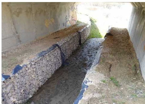
Rys. 4.90. Przepust skrzynkowy zintegrowany z przejściem dla małych zwierząt z półkami z koszy kamiennych – niewielkie uszkodzenie geomembrany nieutrudniające migracji zwierząt
