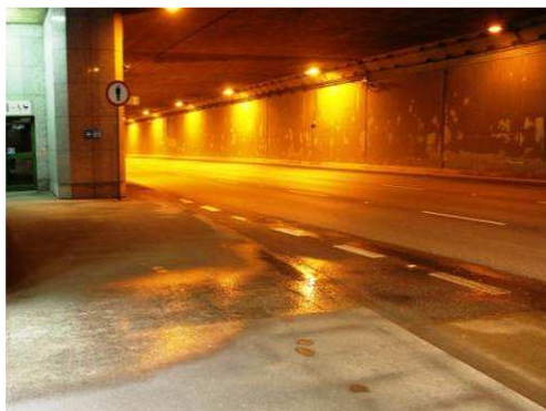
Rys. 3.69. Niewielkie, lokalne przecieki na stropie oraz woda gromadząca się na nawierzchni świadczące o nieskutecznej izolacji
