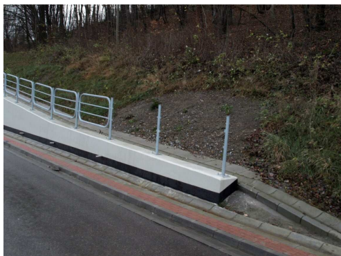
Rys. 5.11. Brak fragmentu balustrady
