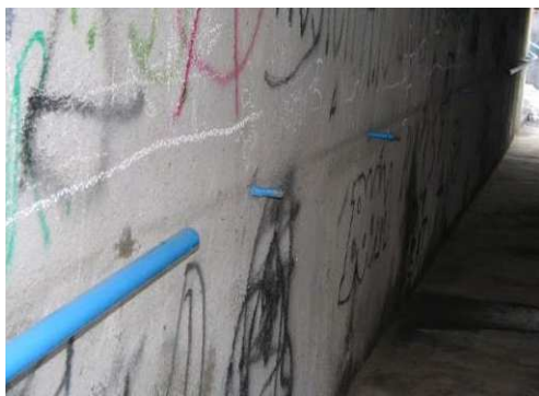
Rys. 3.22. Brak poręczy balustrady
