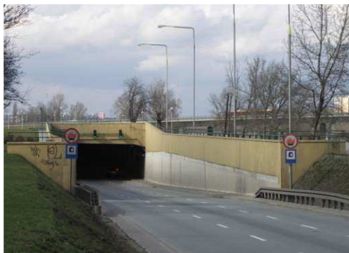
Rys. 3.92. Stan sygnalizacji i oznakowania bez zastrzeżeń
