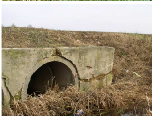
Rys. 4.71. Rysy i pęknięcia głowicy, przemieszczenie fragmentu głowicy wlotowej
