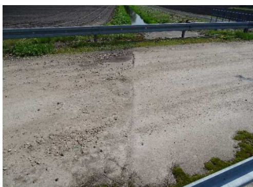
Rys. 4.13. Ubytki i przemieszczenia nawierzchni na dojeździe do przepustu, nierówności progowe, wegetacja na nawierzchni i poboczach gruntowych, zanieczyszczenie nawierzchni
