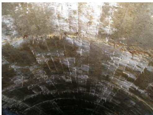
Rys. 3.67. Rozległe przecieki świadczące o nieskutecznej izolacji
