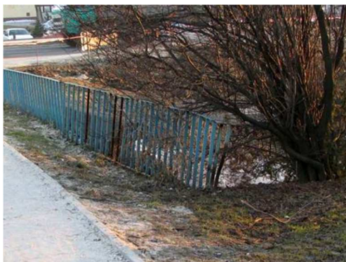
Rys. 4.19. Zniszczenie powłoki antykorozyjnej, korozja, deformacja i przemieszczenie balustrady
