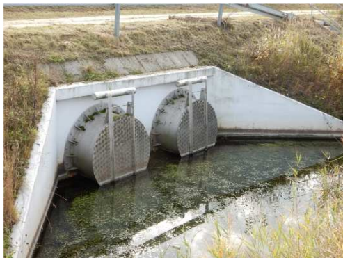
Rys. 4.85. Niewielkie zanieczyszczenie klap zwrotnych zamocowanych do głowicy przepustu dwuotworowego
