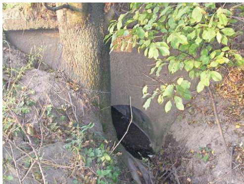
Rys. 4.81. Drzewo rosnące w korycie ciekutrudniające przepływ wody i zagrażające konstrukcji przepustu
