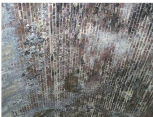
Rys. 3.40. Przecieki, ubytki oraz wykwyty i osady na sklepieniu z cegły świadczące o korozji materiału
