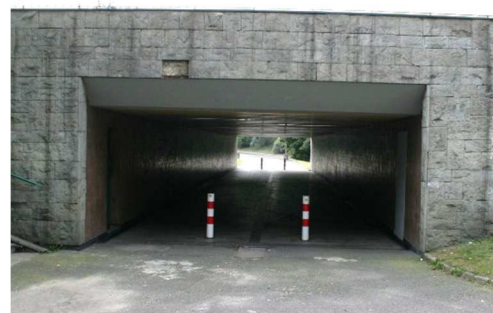
Rys. 3.59. Odpadanie okładziny kamiennej ze ściany czołowej zagrażające bezpieczeństwu pieszych
