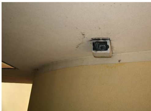
Rys. 3.105. Kamera monitorująca ruch w przejściu podziemnym bez uszkodzeń, widoczne jedynie zanieczyszczenia obudowy
