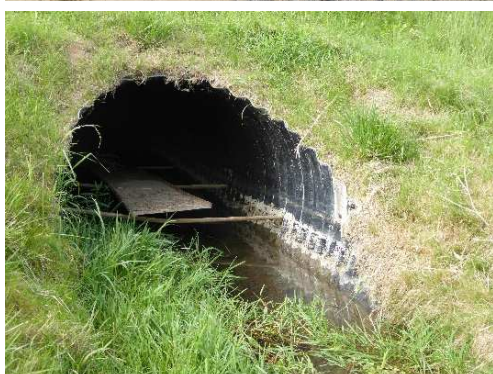
Rys. 4.96. Przepust z blachy falistej zintegrowany z przejściem dla małych zwierząt z półką z blachy stalowej – na wlotach brak pomostów umożliwiających wejście na półkę z terenu, brak ciągłości szlaku migracyjnego
