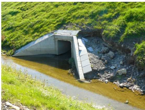
Rys. 4.9. Ubytki gruntu zagrażające stateczności nasypu i głowicy przepustu. Przemieszczenia płyt umacniających skarpe przepustu
