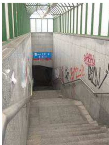
Rys. 3.55. Kamienna okładzina ścian przy wejściu do tunelu zanieczyszczona (graffiti), pogorszona estetyka obiektu
