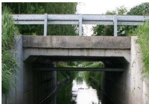
Rys. 4.86. Rura osłonowa urządzenia obcego bez uszkodzeń
