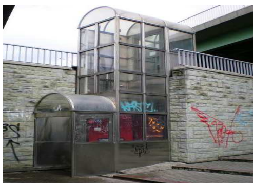
Rys. 3.100. Zanieczyszczenia obudowy szybu windy (graffiti) w przejściu podziemnym
