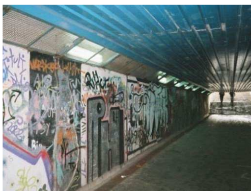
Rys. 3.73. Część elementów oświetlenia uszkodzona i niesprawna
