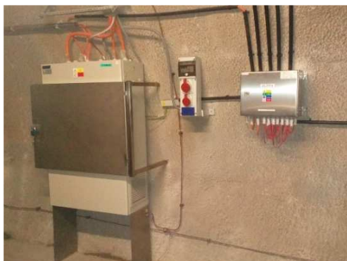
Rys. 3.103. Urządzenia bezpieczeństwa w tunelu bez zastrzeżeń, odpowiednie oznakowanie i zabezpieczenie
