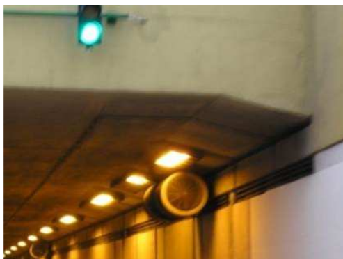
Rys. 3.76. Sprawnie działające urządzenia wentylacyjne
