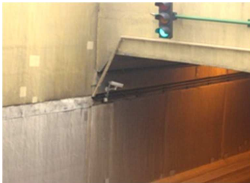
Rys. 3.96. Prawidłowo zabezpieczone i utrzymane urządzenia obce (przewody telekomunikacyjne)
