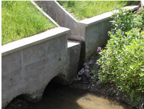
Rys. 4.26. Odwodnienie sprawnie działające, bez uszkodzeń, niewielkie zanieczyszczenia. Wskazane jest wykonanie krótkiego ścieku na skarpie
