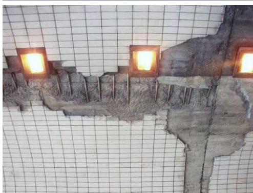
Rys. 3.42. Miejscowe ubytki betonu sklepienia, odstonięte i skorodowane pręty zbrojeniowe
