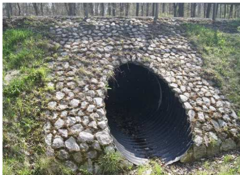
Rys. 4.2. Wegetacja na kamiennym umocnieniu skarpy wymagająca prac pielęgnacyjnych i obniżająca estetykę
