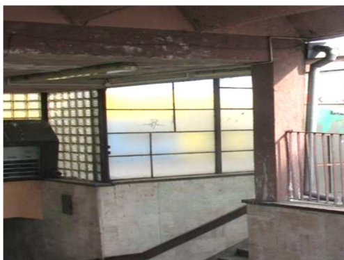
Rys. 3.45. Niewielkie (nieprzekraczające 5% powierzchni) zaciek i wykwyty na podporze świadczące o rozwijającej się korozji ługującej
