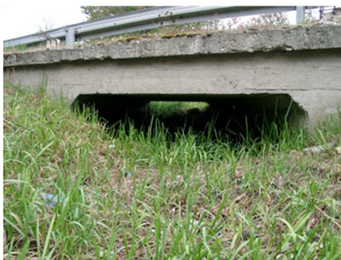
Rys. 4.82. Zanieczyszczenia koryta ciekutrudniające przepływ wody, nadmierna wegetacja, przemieszczenie gruntu
