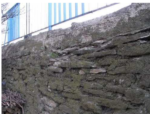
Rys. 5.24. Ubytki materiału konstrukcji, zniszczenie struktury kamienia, zniszczenie spoin elementów kamiennych, wegetacja roślin
