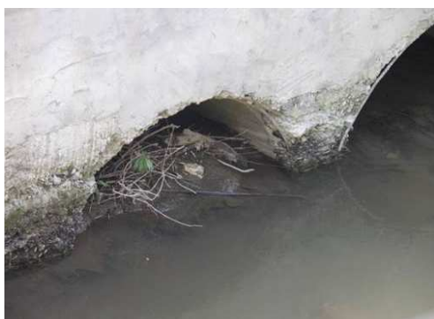
Rys. 4.52. Zanieczyszczenia przewodu powyżej 30% powierzchni przekroju
