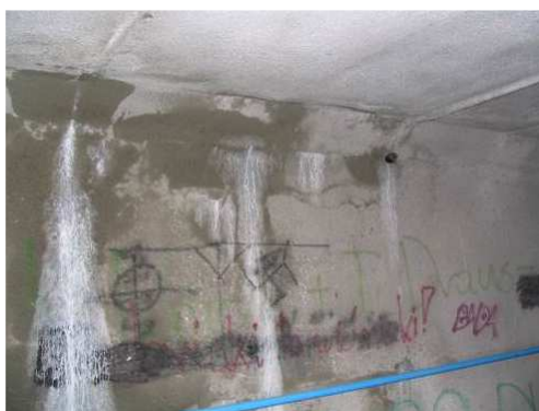
Rys. 3.68. Rozległe przecieki świadczące o nieskutecznej izolacji
