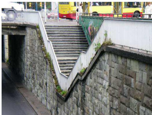
Rys. 5.53. Zanieczyszczenia i wegetacja roślin na gzymsie
