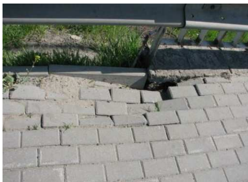
Rys. 4.15. Obniżenie nawierzchni chodnika nad przepustem na skutek wyflukania zasyпки
