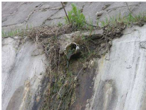
Rys. 5.44. Zanieczyszczona, zbyt krótka rura odwadniająca, częściowo ograniczająca przepływ wody. Intensywna korozja
