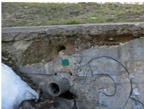
Rys. 4.28. Rura odprowadzająca wodę z jezdni nad przepustem w dość dobrym stanie, niespełniająca jednak swojej funkcji z powodu całkowitego zanieczyszczenia kratki ściekowej. Woda penetruje zasypkę, niszcząc głowicę przepustu
