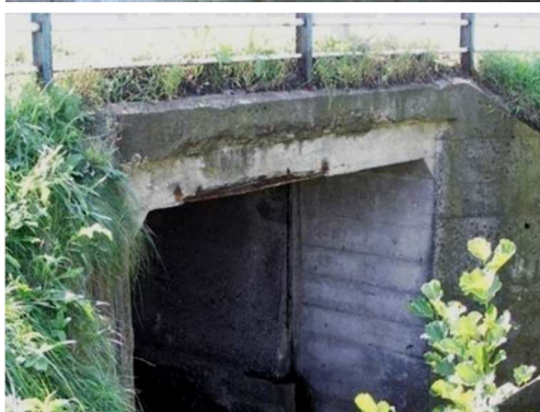
Rys. 4.66. Miejscowe ubytki betonu i korozja zbrojenia
