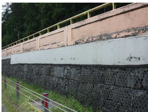
Rys. 5.12. Zniszczenie powłoki malarskiej na barierze betonowej, osady i złuszczenia betonu
