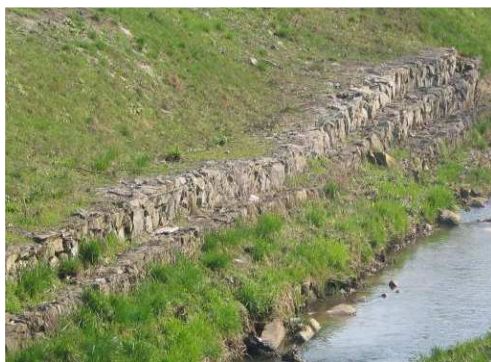
Rys. 5.37. Widoczne przemieszczenie konstrukcji, lokalne ubytki kamieni wypełniających kosze
