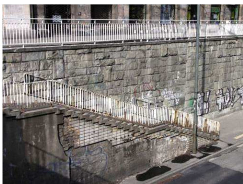
Rys. 5.57. Korozja balustrad, korozja i ubytki okładziny schodów
