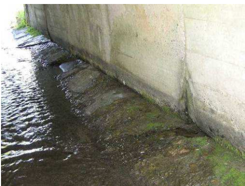
Rys. 4.49. Niewielkie ubytki materiału płyty dennej przepustu sklepionego
