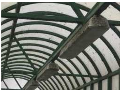
Rys. 3.72. Zanieczyszczenia elementów oświetlenia
