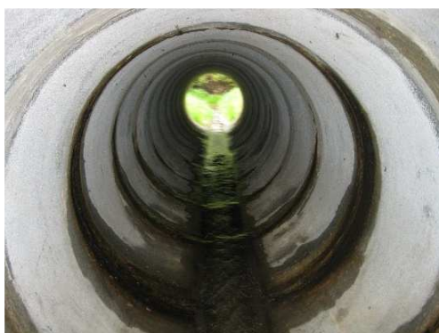
Rys. 4.34. Przecieki wody na całym obwodzie styków/złączy betonowych elementów rurowych świadczące o całkowitym uszkodzeniu izolacji lub jej braku
