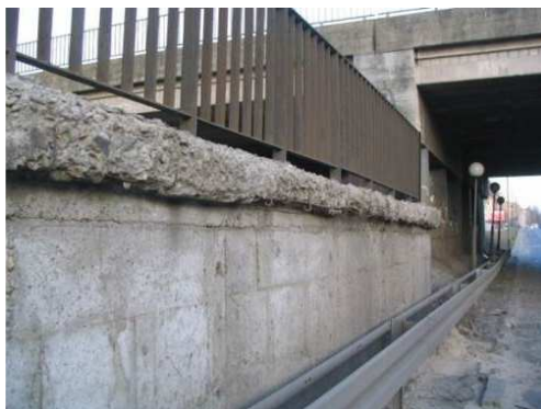
Rys. 5.54. Gzyms zniszczony, ubytki betonu, zacieki, osady
