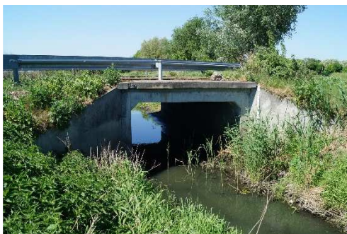
Rys. 4.7. Wegetacja roślinności wymagająca prac utrzymaniowych, zagrażająca trwałości nasypu i skarpy
