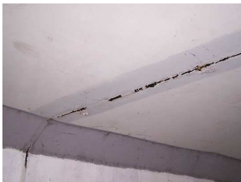
Rys. 3.39. Uszkodzenie uszczelnienia styku technologicznego w przejściu podziemnym, miejscowe przecieki i początki korozji betonu
