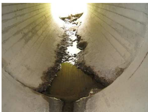
Rys. 4.60. Obszerne ubytki i zniszczenie struktury betonu monolitycznego przepustu o konstrukcji rurowej zagrażające nośności przepustu
