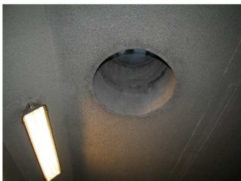
Rys. 3.80. Element systemu wentylacji w stropie tunelu drogowego bez uszkodzeń
