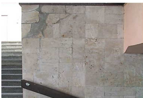
Rys. 3.57. Występujące na ścianie tunelu ubytki okładziny kamiennej uzupełnione zaprawą, pogorszona estetyka obiektu
