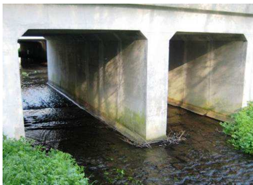
Rys. 4.63. Niewielkie zanieczyszczenia, początki wegetacji roślin
