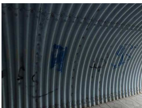
Rys. 3.37. Korozja śrub łączących arkusze blachy, zniszczenie cynkowej powłoki antykorozyjnej, zanieczyszczenie graffiti na blachach falistych
