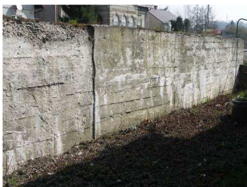
Rys. 5.19. Widoczne ubytki i korozja betonu. W wielu miejscach beton wykazuje oznaki zniszczenia struktury
