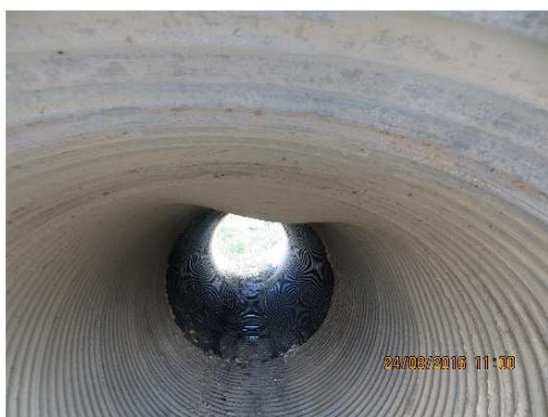
Rys. 4.59. Deformacja i przemieszczenie powłoki stalowej przepustu z blach falistych, zmniejszenie światła o ok. 20%
