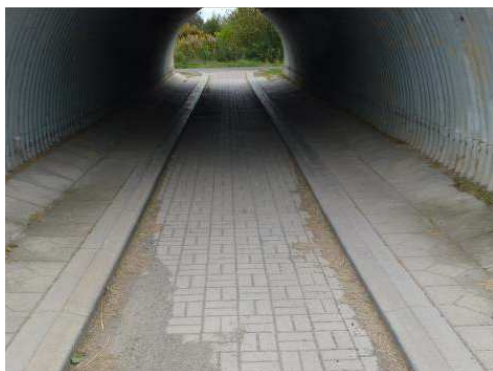
Rys. 3.17. Zanieczyszczenie piaskiem i niewielka wegetacja roślinności na nawierzchni w przejściu podziemnym
