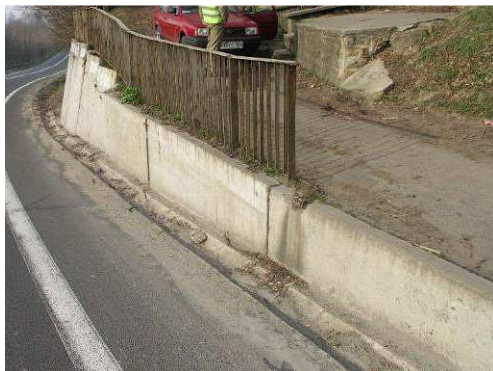
Rys. 5.9. Całkowite zniszczenie powłoki anty-korozyjnej, początki korozji balustrady
