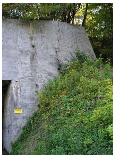
Rys. 3.2. Wegetacja roślinna na skarpie pogarszająca estetykę obiektu
