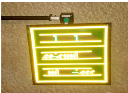
Rys. 3.93. Stan oznakowania wskazującego na kierunek ewakuacji w sytuacji awaryjnej bez zastrzeżeń
