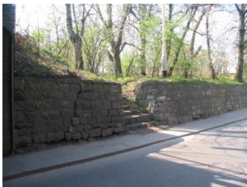
Rys. 5.27. Pęknięcie korpusu konstrukcji i przemieszczenie części elementów
