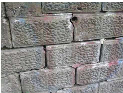
Rys. 5.26. Wyfłukanie spoin elementów konstrukcji oporowej
