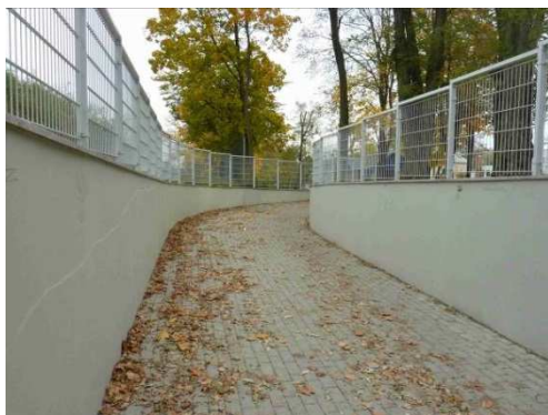
Rys. 3.84. Zanieczyszczenie nawierzchni pochylnej
