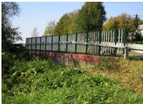
Rys. 4.18. Zniszczenie powłoki antykorozyjnej i początki korozji balustrady nad przepustem
