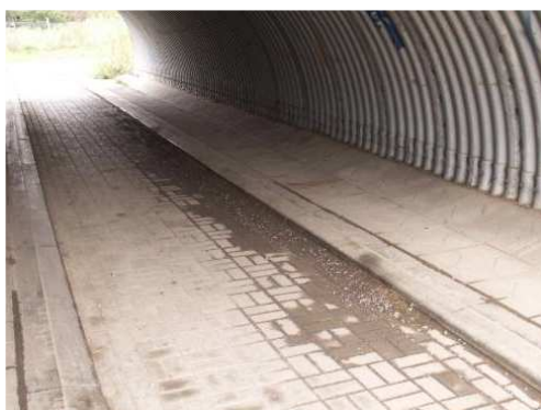
Rys. 3.63. Odwodnienie powierzchniowe przejścia podziemnego ze zbyt małymi spadkami, zanieczyszczenia i zastoiska wody wzdłuż ścieków przykrawężnikowych
