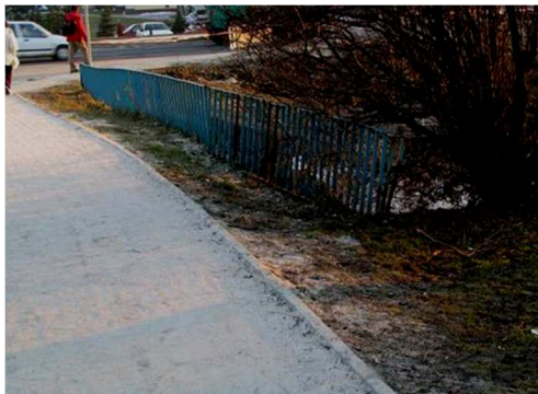
Rys. 4.14. Zanieczyszczenia chodnika nad przepustem
