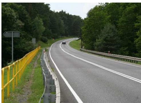
Rys. 4.12. Deformacje nawierzchni jezdni nad przepustem i dojazdami (do 20 mm), sfalowania widoczne na środkowej linii podwójnej ciągłej P4
