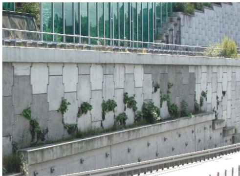
Rys. 5.29. Wegetacja roślin zagrażająca trwałości konstrukcji z elementów prefabrykowanych
