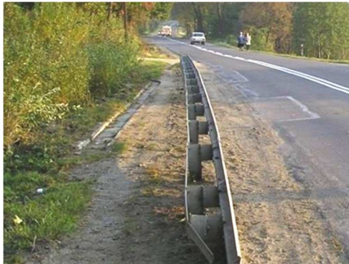
Rys. 4.27. Ściek odwadniający ułożony zbyt wysoko. Część wody opadowej przepływa obok ścieku
