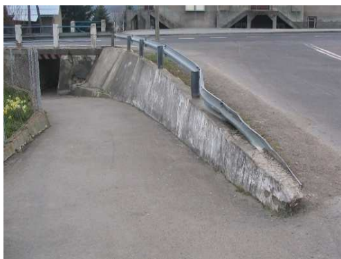
Rys. 5.10. Zdeformowana bariera, uszkodzone połączenie bariery ze słupkami
