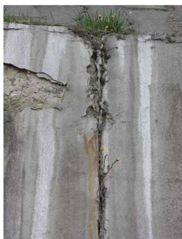
Rys. 5.51. Widoczne ubytki i korozja betonu, rdzawe zacieki oraz wegetacja roślin
