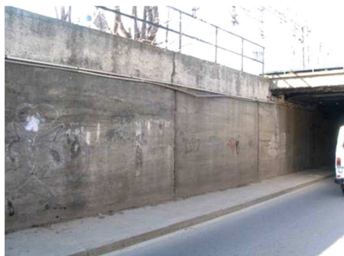
Rys. 5.62. Miejscowe uszkodzenie zamocowania przewodu telekomunikacyjnego i osłony z tworzywa sztucznego
