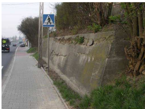
Rys. 5.18. Ubytki betonu sięgające głębokości 50 mm, występujące na połowie długości korpusu w miejscu przerwy w betonowaniu (powierzchnia ubytków ok. 10%). Poziome rysy i pęknięcia w korpusie, przez rysy przedostaje się woda, przyspieszając korozję
