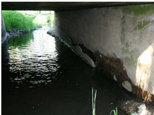
Rys. 4.44. Korozja i ubytki materiału ściany obniżające nośność przepustu, rysy i zawilgoce nie ścian
