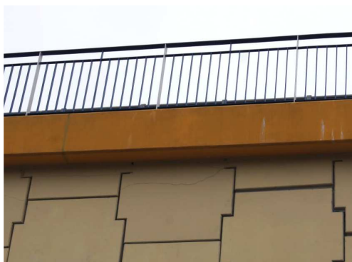
Rys. 5.31. Rysy o rozwarości 0.6 mm na dwóch prefabrykatach konstrukcji (mały zakres uszkodzeń, rysy ustabilizowane)
