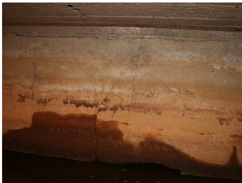
Rys. 4.43. Widoczne pionowe pęknięcia o rozwarości ponad 1.5 mm, powstałe na skutek przeciążenia. Ubytki betonu, osady i zacieki
