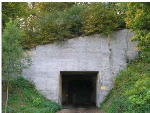
Rys. 3.28. Zarysowania betonu na ścianie czołowej o rozwarłości do 0.5 mm, wykwyty świadczące o korozji ługującej oraz ubytki betonu
