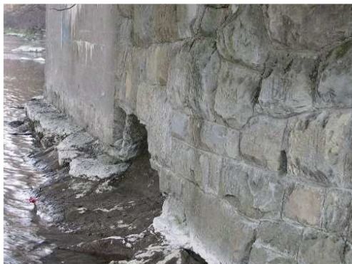
Rys. 5.23. Ubytki elementów korpusu na skutek podmycia
