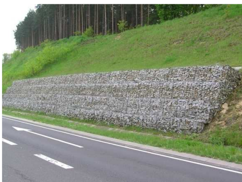
Rys. 5.34. Konstrukcja oporowa z koszy siatkowych bez uszkodzeń
