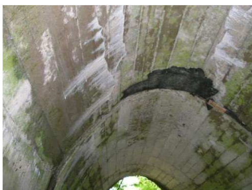
Rys. 4.32. Przecieki, zacieki oraz korozja betonu sklepienia świadczące o całkowitym uszkodzeniu izolacji przepustu
