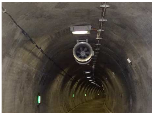
Rys. 3.79. Sprawnie działające urządzenia wentylacyjne w tunelu ewakuacyjnym
