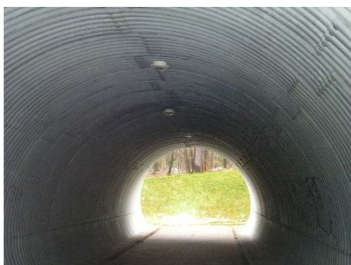
Rys. 3.74. Urządzenia oświetlenia kompletne i sprawne, bez uszkodzeń
