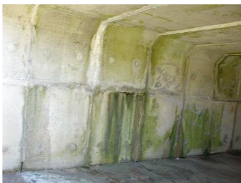
Rys. 4.65. Wegetacja glonów i porostów, lokalne ubytki betonu, przecieki przez styki oraz osady i wylugowania na elementach ramowych przepustu
