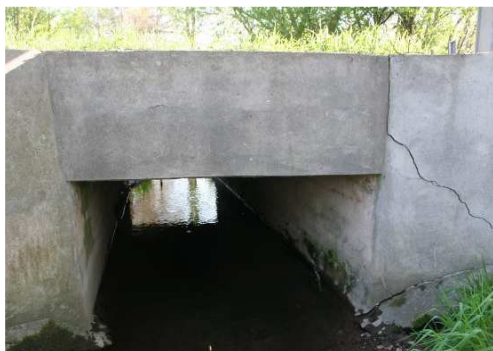
Rys. 4.74. Pęknięcie głowicy zagrażające jej trwałości
