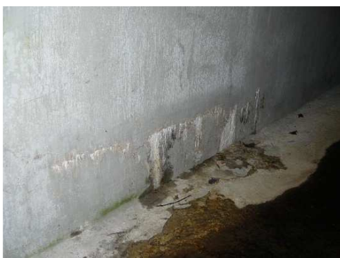
Rys. 4.45. Widoczne lokalne, poziome zarysowanie z białym wyługowaniem i zawilgoce niem świadczące o przecieku przez ścianę wysokiego przepustu sklepionego
