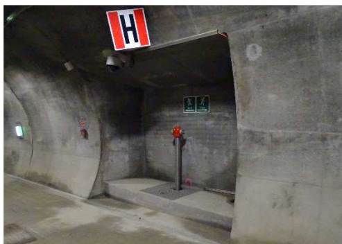
Rys. 3.106. Stan techniczny hydrantu przeciwpożarowego bez zastrzeżeń
