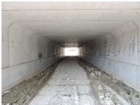
Rys. 4.62. Niewielkie zanieczyszczenie (do 5%) graffiti na elementach ramowych przepustu
