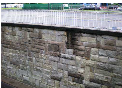
Rys. 5.47. Miejscowe przecieki wody świadczące o nieskutecznej izolacji
