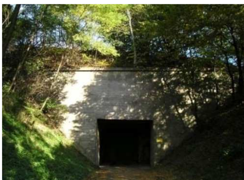
Rys. 3.91. Bujna wegetacja roślin na terenie nad tunelem zagrażająca jego trwałości
