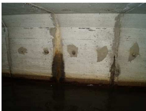
Rys. 4.36. Lokalny przeciek przez dwa styki/złącza pionowe prefabrykowanych elementów przepustu ramowego/skrzynkowego
